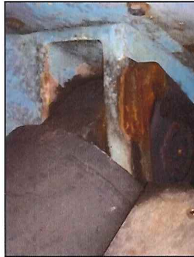
Local: Lança Item # 49: pino de junção inferior do cilindro de elevação direito sem o parafuso de fixação (se encontra soldado). Status: corrigido .
